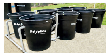
Planta de potabilización de agua
